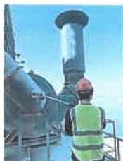
◎1DA001 装卸船机排放口 1#
