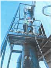
◎22DA023 C 水泥库排放口 22#
