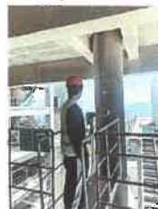
◎16DA016 生料入磨排放口 16#
