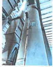
●32DA033 2号熟料 料柜排放口 32#
