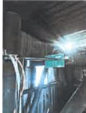
◎10DA010 煤仓出仓 2#转站排放口
