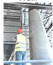
◎31DA032 1号熟料料柜排放口 31#
