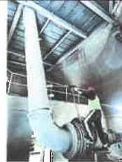
◎DA007 2#散装机排放口 7#
